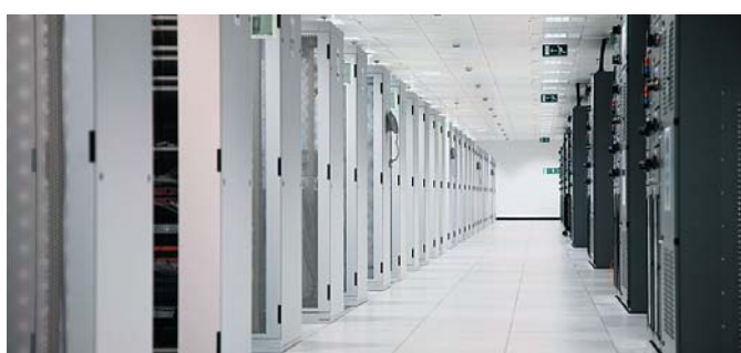
DATA-центр, емкость которого — 52 технологические стойки, согласно требованиям международной классификации, относится к уровню надежности tier 3.
